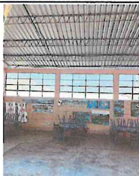
Foto 3: Ventanas en mal estado
