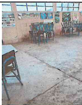
Foto 5: Deterioro estructura de ventanas
