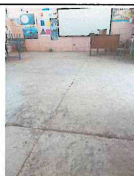
Foto 6: Deterioro de plancha de cemento
